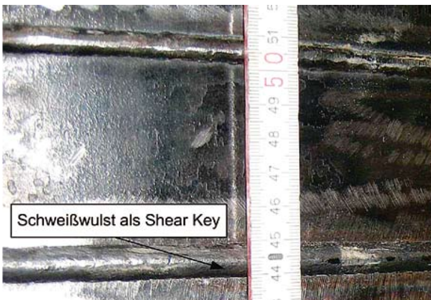
Schweißwulste als Schubrippen bringen zusätzlich zur Reibschlussverbindung eine Formschlusskraft in die Grouted Joints ein.
